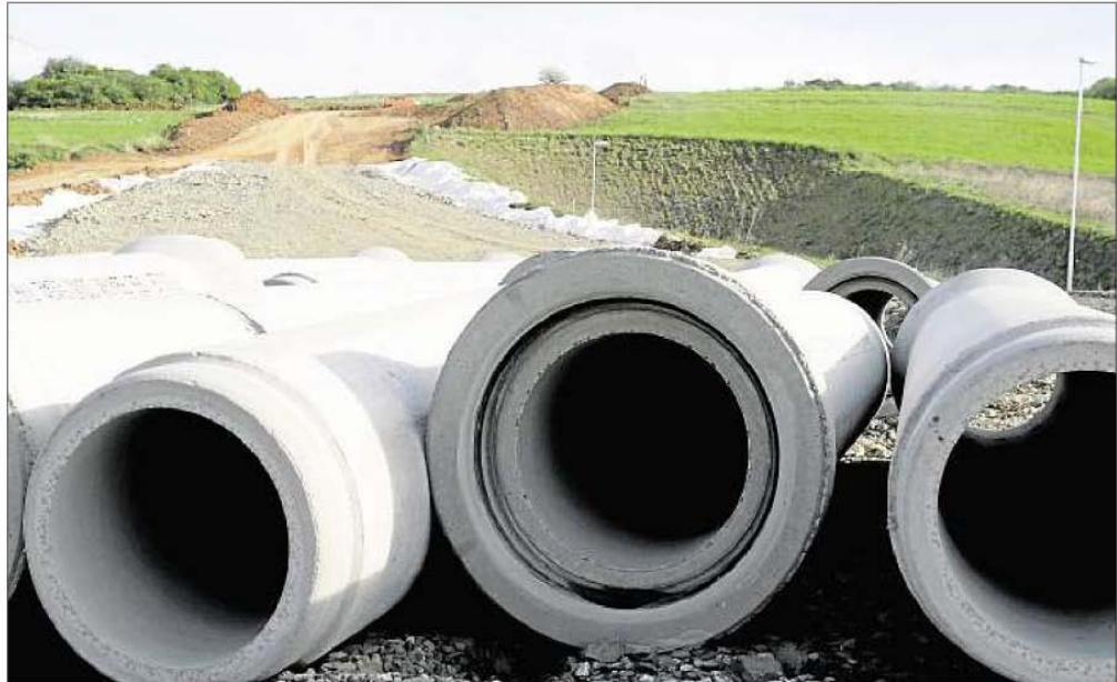
Die Baustelle für die Teilortsumgehung von Dehrn. Und wieder verschwindet Land für die Bauern.
